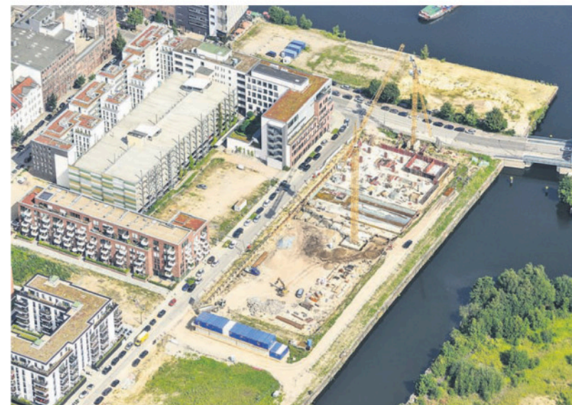
Blick auf einer Großbaustelle im Harburger Binnenhafen: In der Bildmitte wächst das Brückenquartier (Bericht siehe oben), auf der freien Fläche darüber sollen das neue Hotel und die L'Osteria gebaut werden. Die Kaimauerabsenkung ist für den freien Platz zwischen der L'Osteria und dem Kaispeicher (oben links) geplant.
