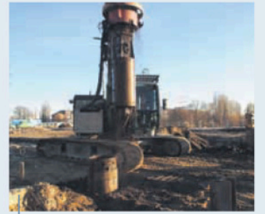
Das ehemalige Güterbahn-Gelände im Harburger Binnenhafen: Hier werden 23 000 Kubikmeter Boden ausgekoffert und entsorgt.
